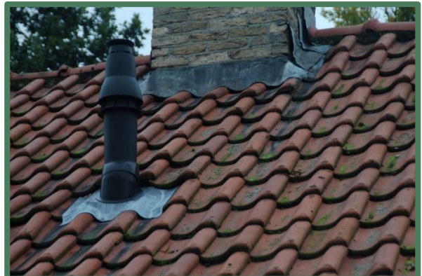
Kierende dakpannen en loodslabben
