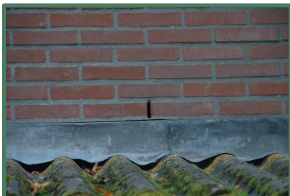
Open stootvoegen en kierende loodslabben
