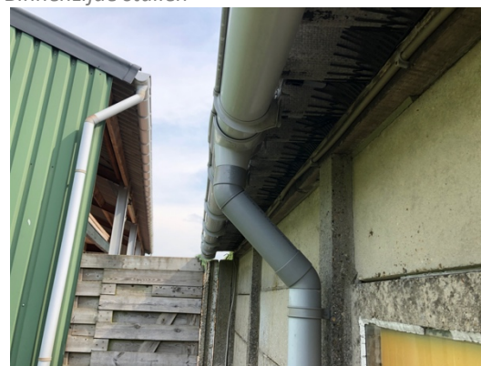
Dakgoot voorzien van afwerking wat geen toegang biedt aan vogels en andere soorten.
