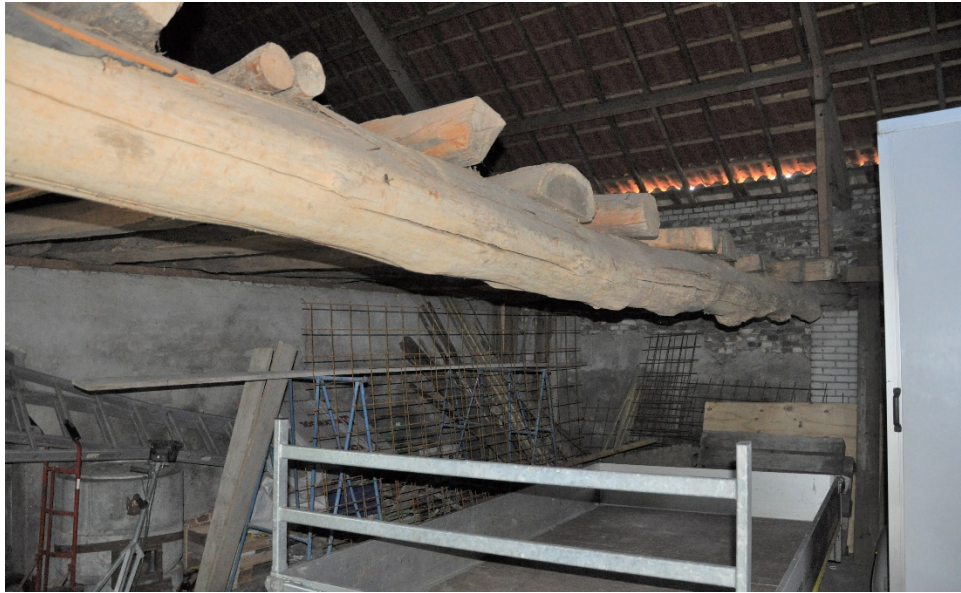
Afb.49. De ongekantrechte moerbalk in de 'deel'.
