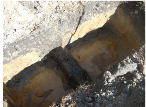
Foto 6 | Foto voor bron Bitumen leidingmantel
