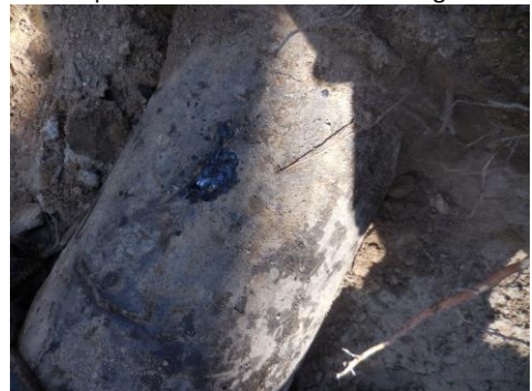
Foto 8 | Foto voor bron Bitumen leidingmantel
