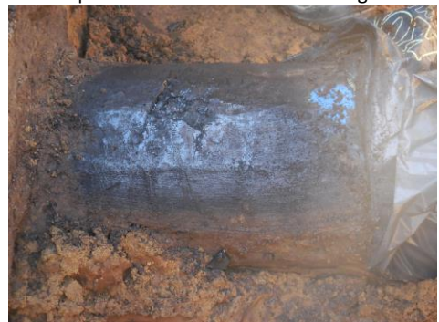
Foto 10 | Foto voor bron Bitumen leidingmantel
