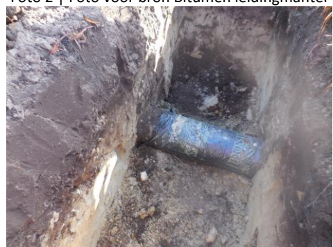
Foto 4 | Foto voor bron Bitumen leidingmantel
