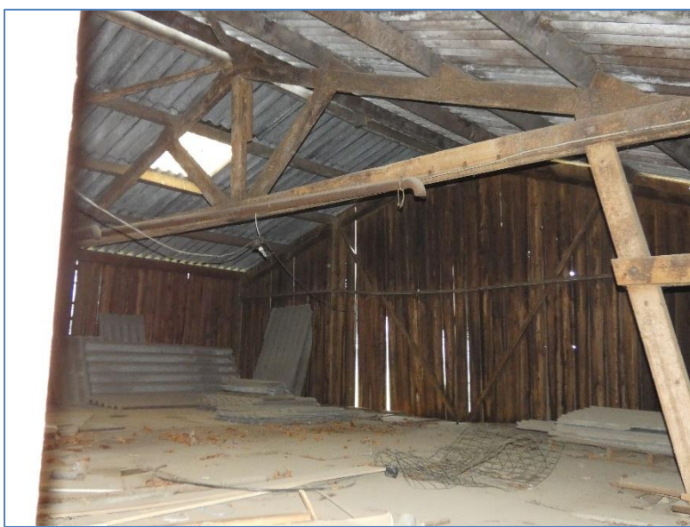
Foto 19 Open, tochtige zolder gedeelte gebouw 5
