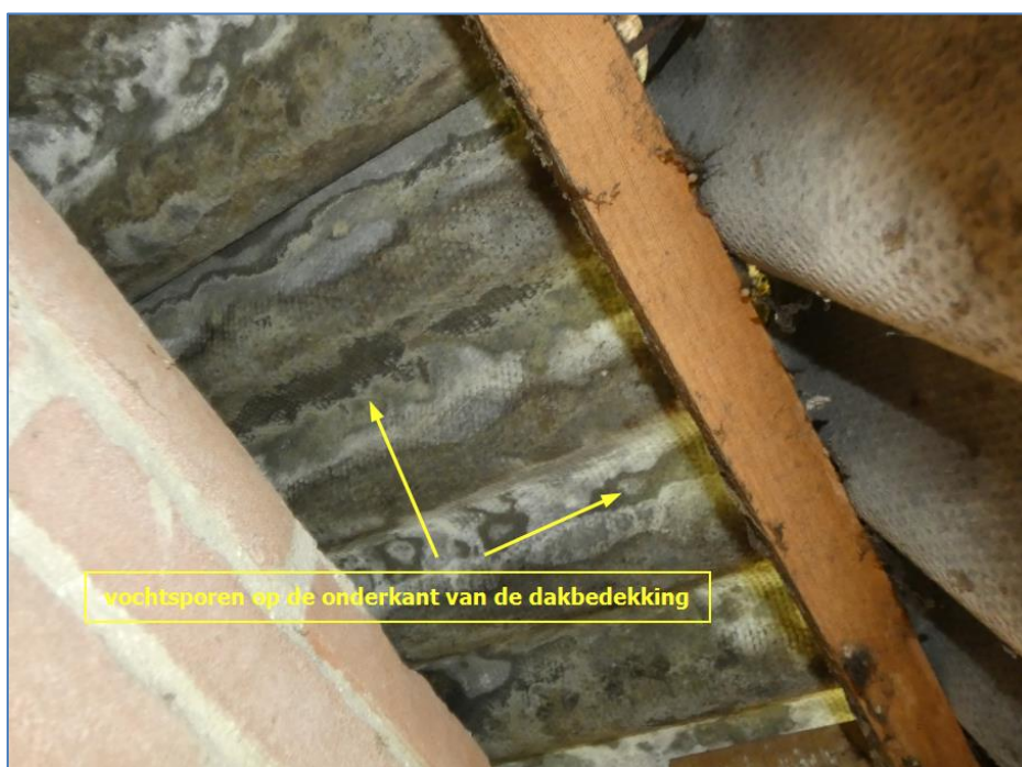
Foto 12 binnenzijde zij-luchtinlaat gebouw 6 (NO zijde)
