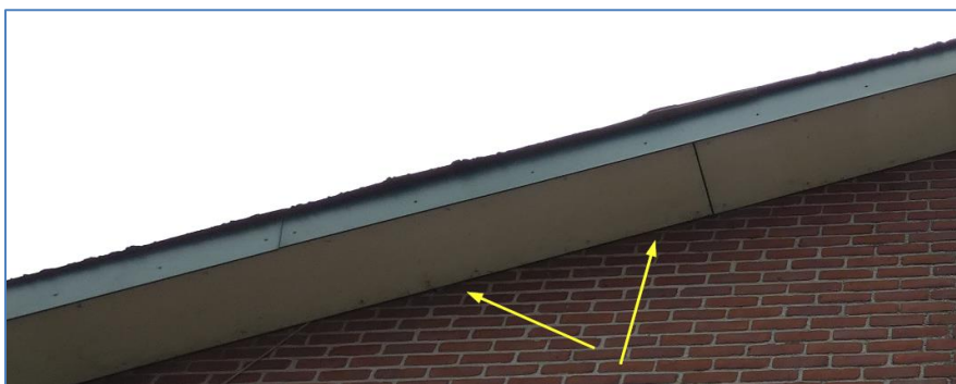
Foto 24 Strakke afdichting ZW gevel huis (gebouw 1) tegen dak
