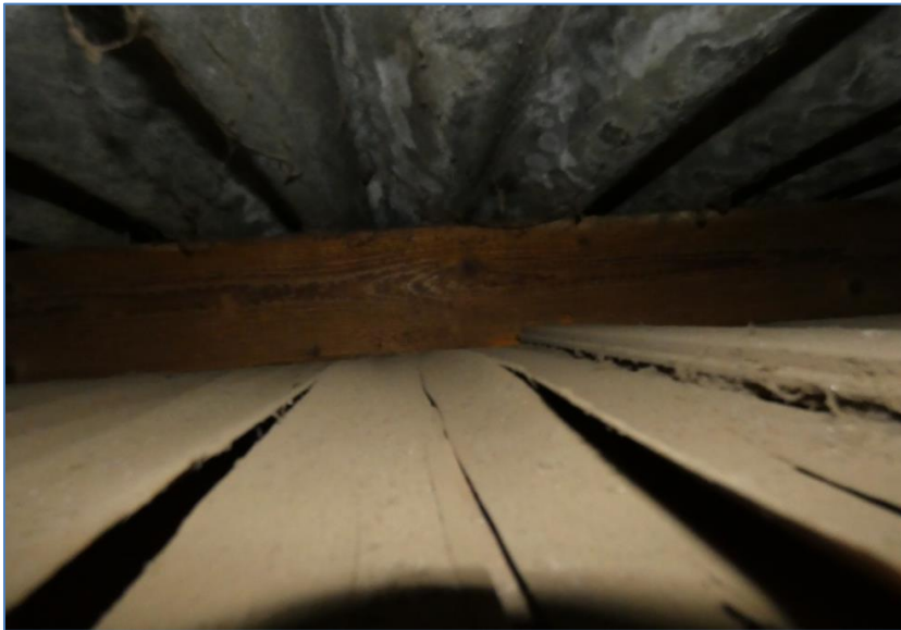
Foto 26 'schone' ruimte tussen golfplaten en dunne houten beschoot gebouw 2
