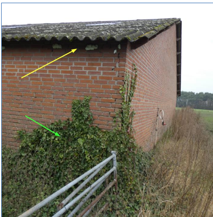
Foto 9 afdichting met pur zijmuur gebouw 6 (gele pijl) en te laag opgroeiende klimop gebouw 6 ZO gevel (groene pijl)
