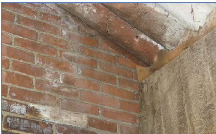
Foto 18 golfafdichting gebouw 3 (muur tegen gebouw 4 aan)
