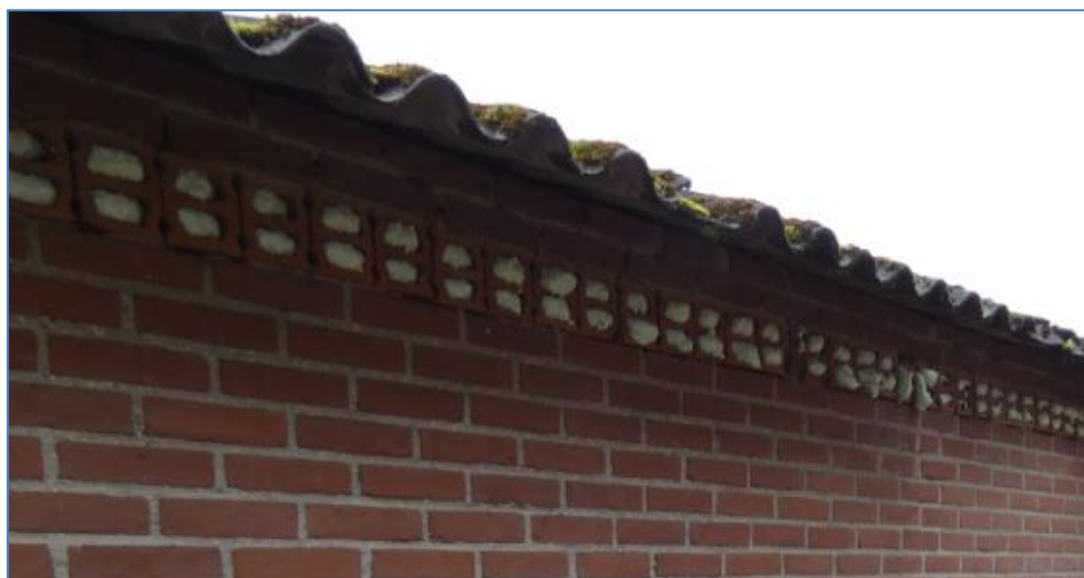
Foto 14 zijgevel gebouw 6 (ZW zijde) met afgedichte zij luchtinlaat.
