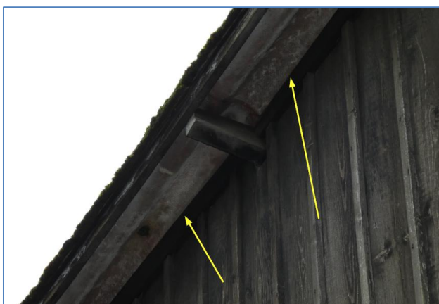
Foto 21 gevelplanken (enkel) strak tegen golfplaten gebouw 5
