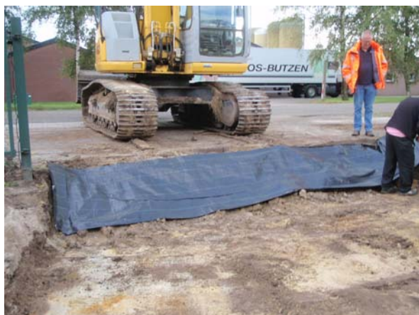
Foto 1: Zicht op de wand W9 waar een restverontreiniging achterblijft.
