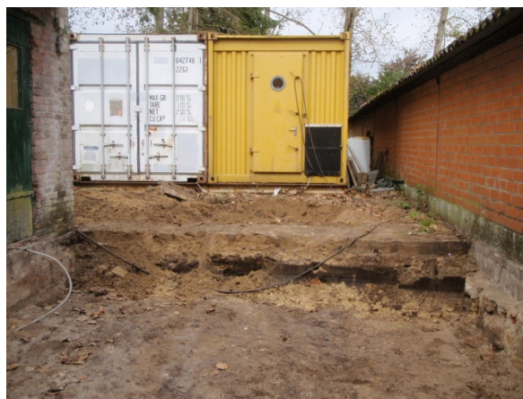
Foto 2: Zicht op de wand W4 die nog verontreinigd blijkt waardoor aanvullend is gesaneerd.
