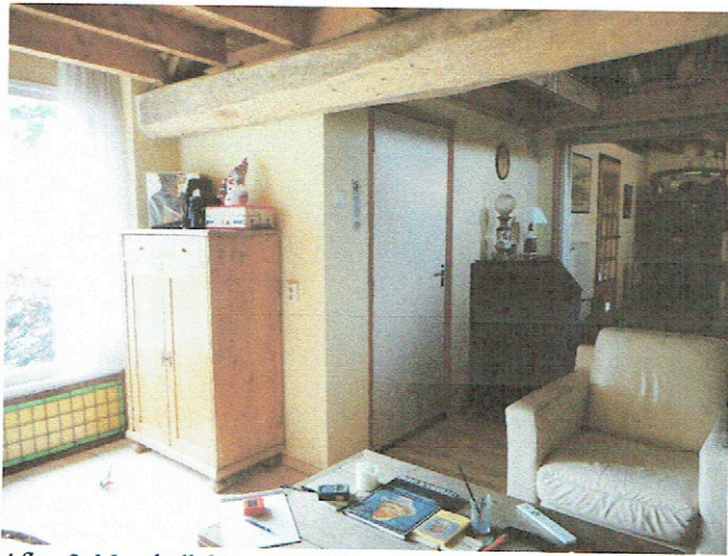
Afb. 38. Moerbalk bij voorgevel.
