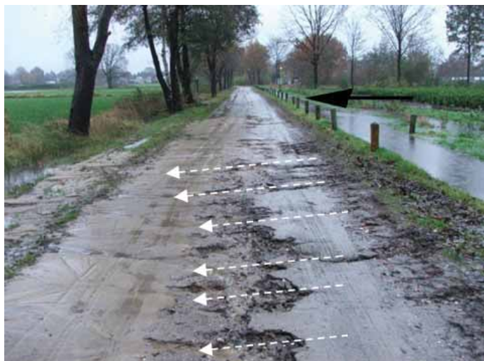
Foto 13 Sporen van overstroming Kerkpad
