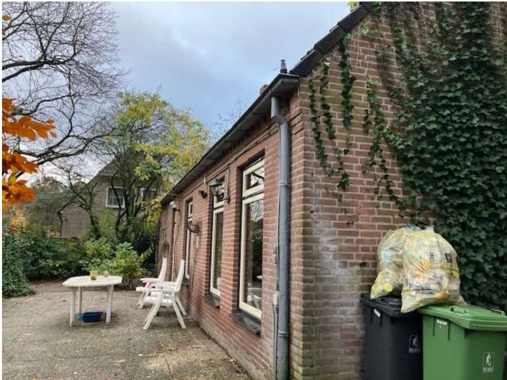
• Afbeelding 22: Achtergevel Stökskesweg 42, dakgoot is laag en strak tegen de gevel
