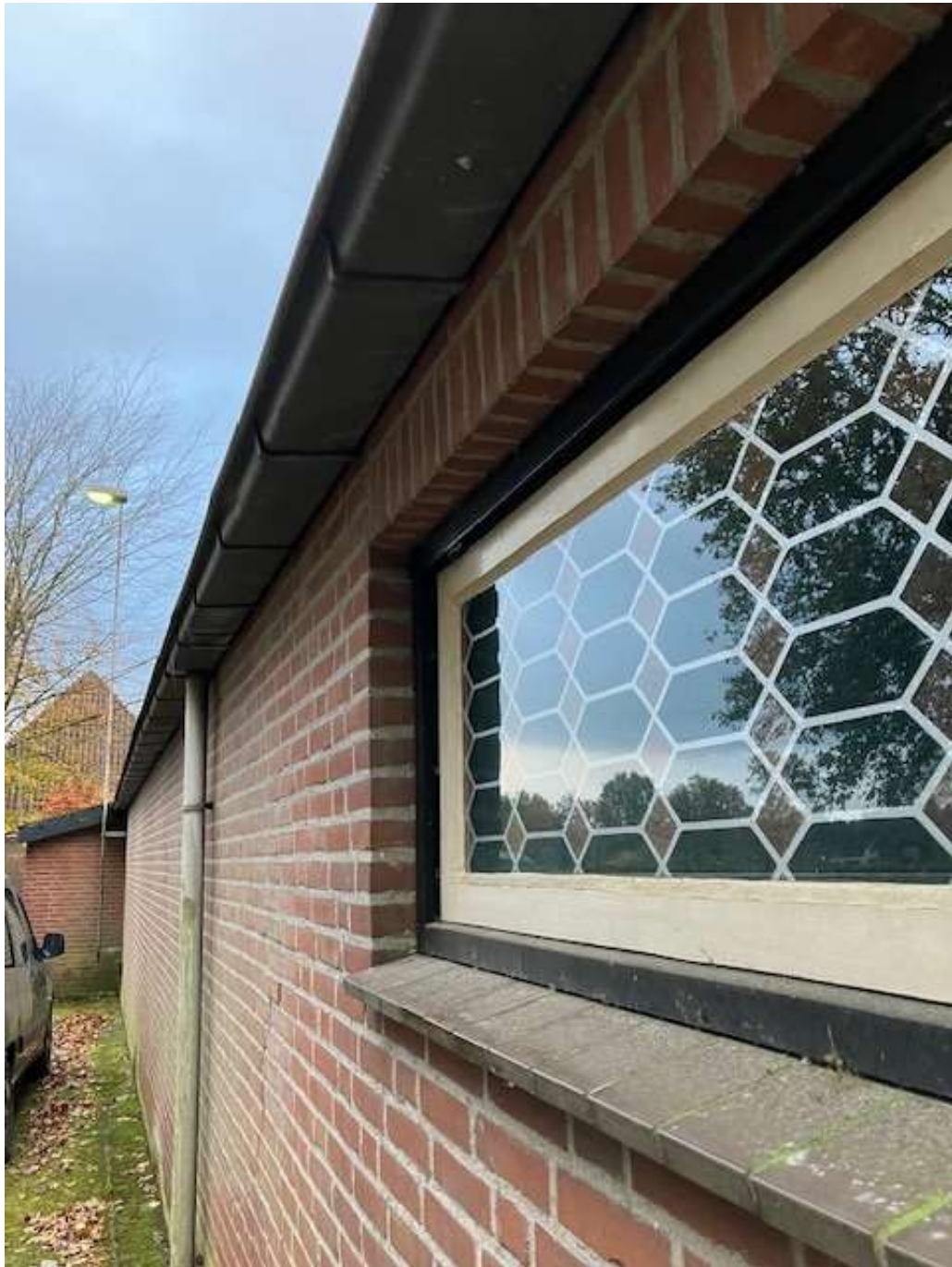
• Afbeelding 9: Onderzijde dakgoot strak tegen de muur
