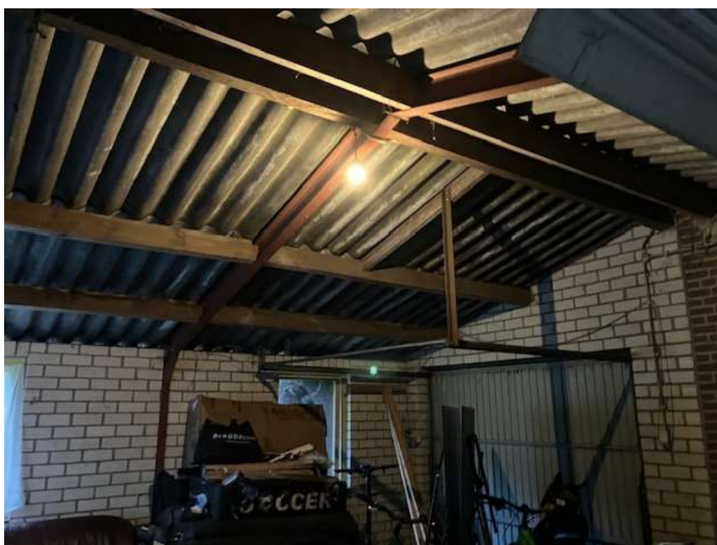
• Afbeelding 25: Binnenzijde garage naast te slopen schuur, ongeïsoleerde asbest golfplaten
