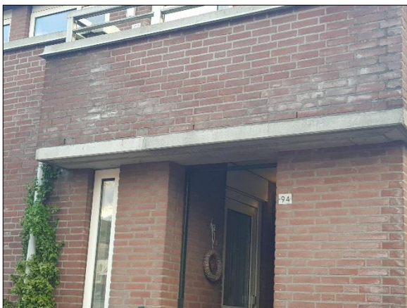
Figuur 9. Open stootvoegen in woningen
