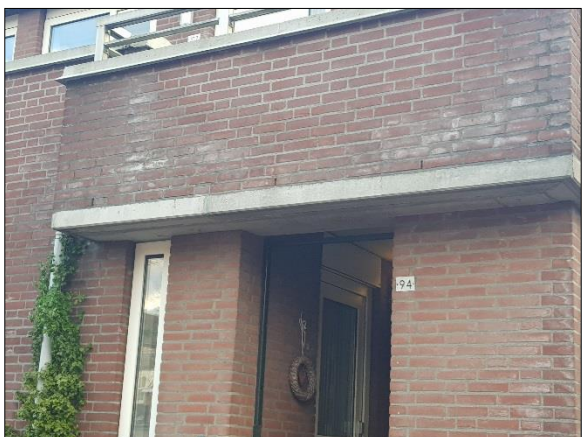
Figuur 9. Open stootvoegen in woningen
