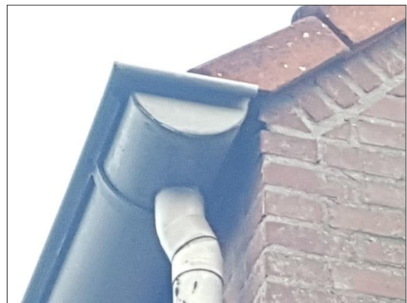
Figuur 10. Opening achter dakgoot
