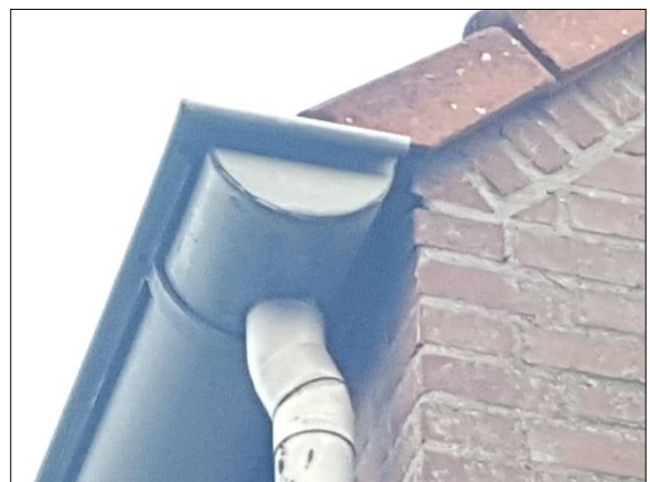
Figuur 10. Opening achter dakgoot
