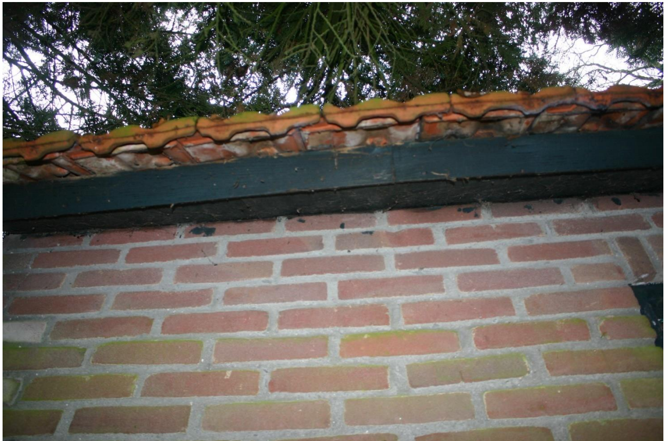
Figuur 4.4.6. Het dak op het voormalige koelhuis bevat kieren waar vleermuizen (maar geen vogels) door naar binnen kunnen.
