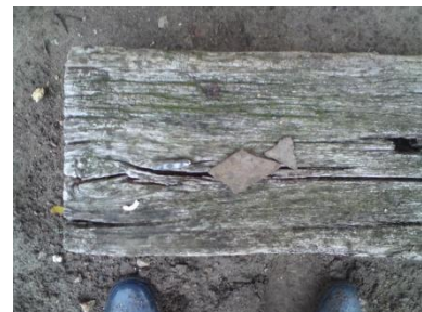
Op de balk twee aangetroffen asbestverdachte stukjes.
