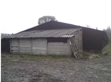
Betonnen aanbouw aan de schuur met daarop asbesthoudende golfplaten. In de schuur staan ook asbesthoudende golfplaten. Van enkele dakplaten zijn stukken gebroken.
