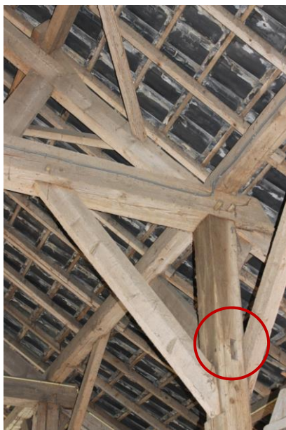
Loos gat van de aansluiting met het schoor
