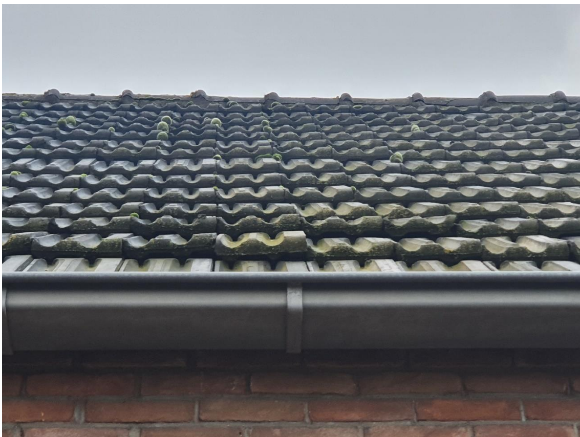
Foto 11. Loszittende dakpannen op de woning
