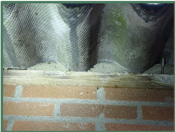
Aangesmeerde asbest platen
