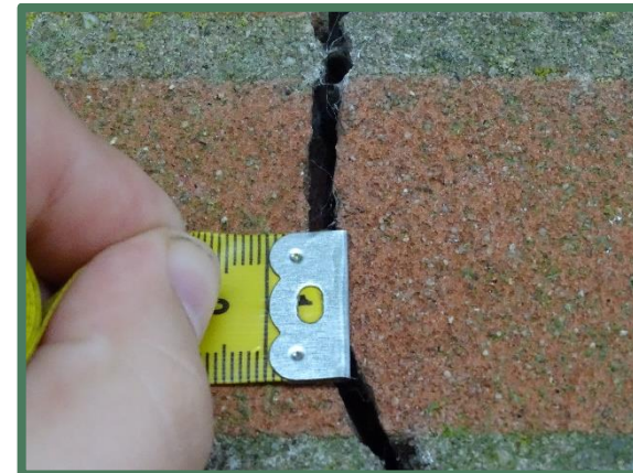
Te kleine scheur in noordelijke wand schuur 2
