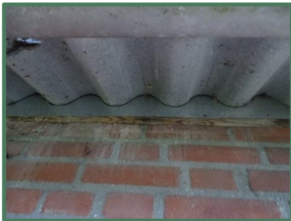
Foto 19: Muurplaat op de wand en vogelschroot onder de golfplaten.
