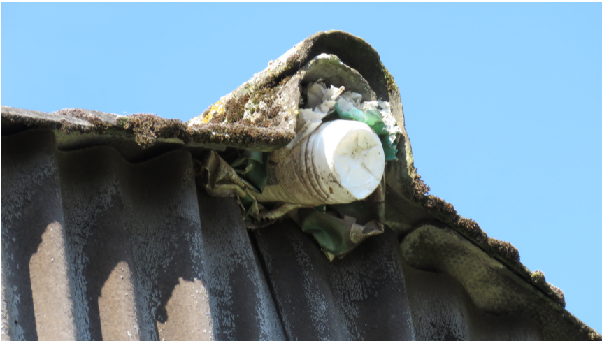
Afbeelding 12: De nok van de garage is afgedicht met plastic. Dit is niet recentelijk gedaan (plastic is zeer oud en vuil).
