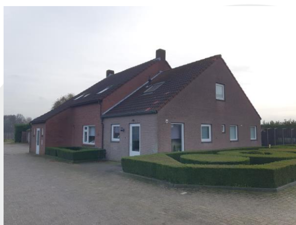
Woning Markweg 5: pannen dak niet strak aangesloten. Enkele gaten/kieren in de gevels; geen vogelschroot.
