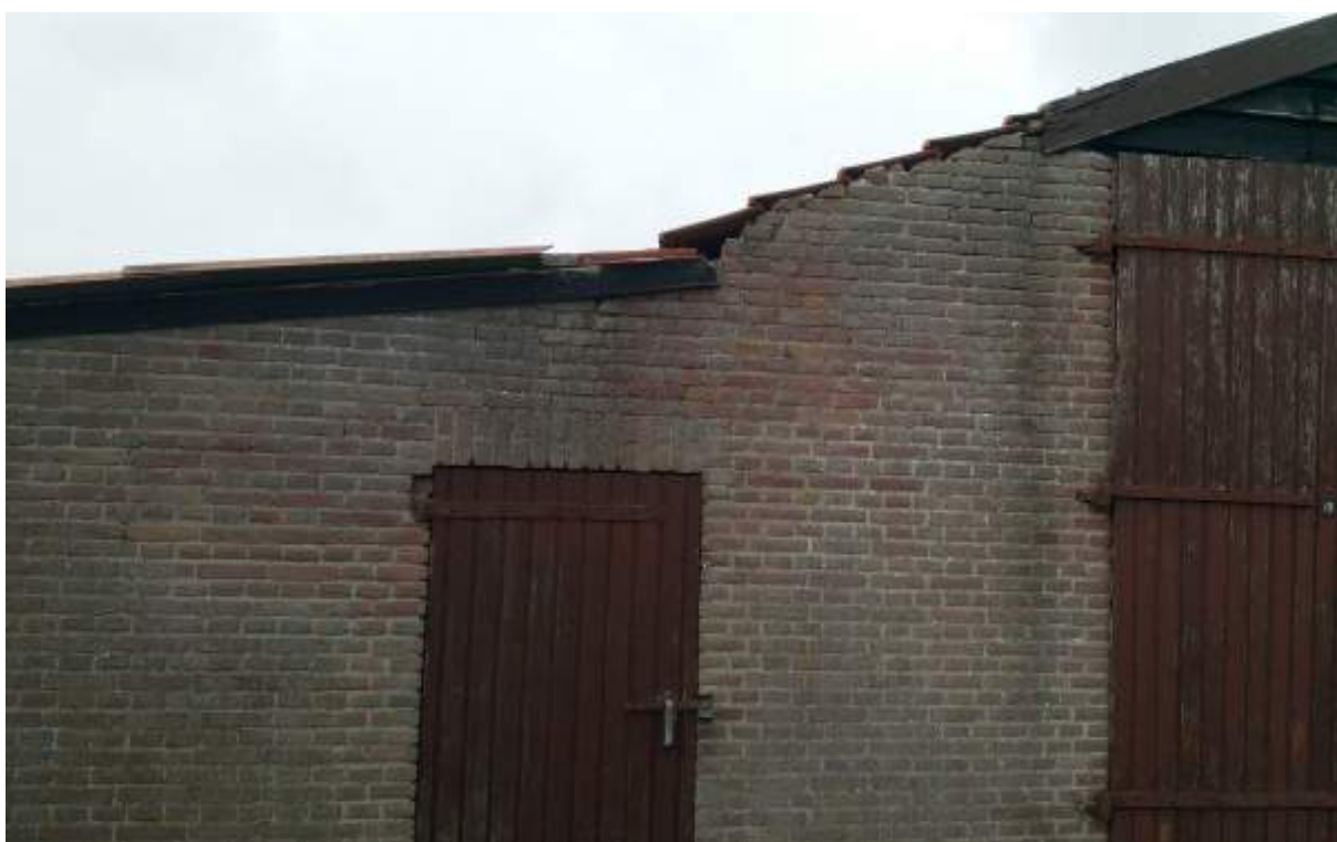
In gebouw 2 zijn allerlei openingen aanwezig door het ontbreken van ruiten en (delen van) stenen of dakpannen. Foto: M. de Vries | Ecoresult B.V.
