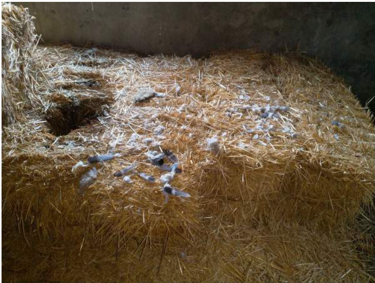
Abbeelding 8. In gebouw 3 werden tijdens het veldbezoek pluuksporen en uitwerpselen gevonden van een marterachtige, vermoedelijk een steenmarter. Foto: M. de Vries | Ecoresult B.V.
