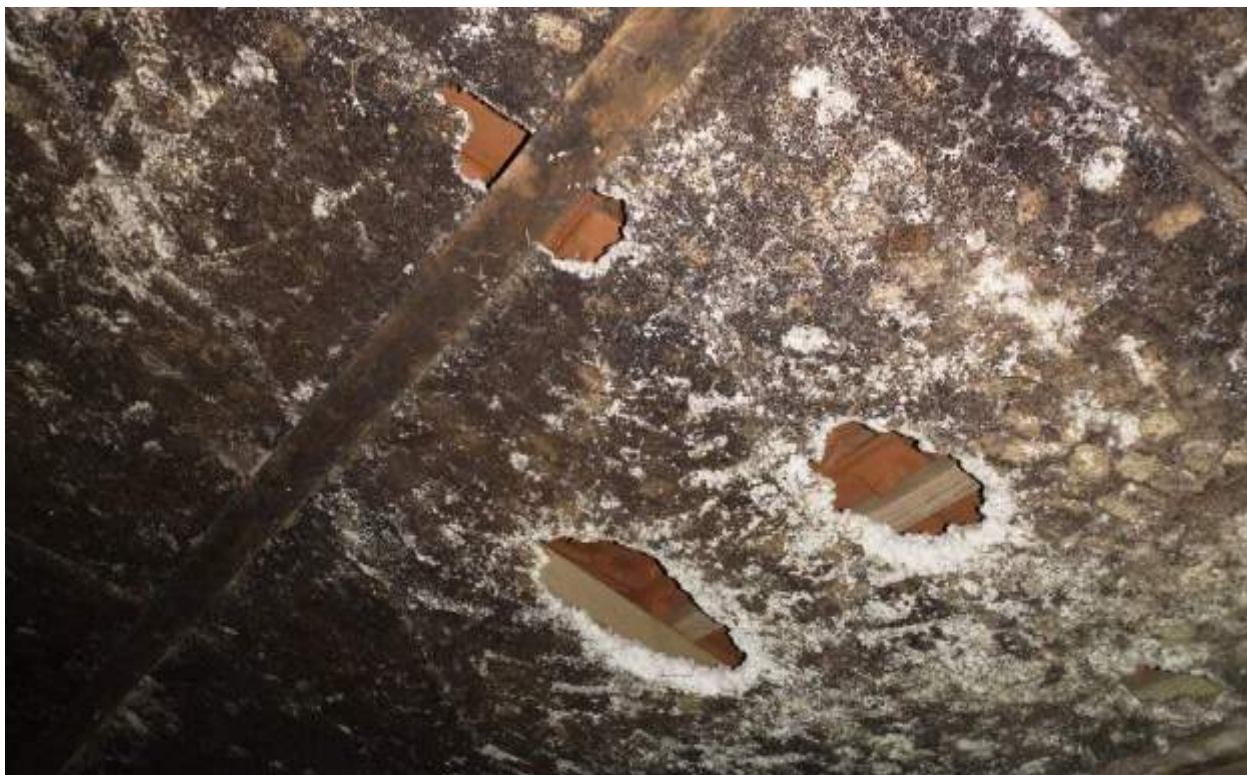
Onder de dakpannen van gebouw 2 is isolatiemateriaal aanwezig, waar veel gaten in aanwezig zijn. Foto: M. de Vries | Ecoresult B.V.
