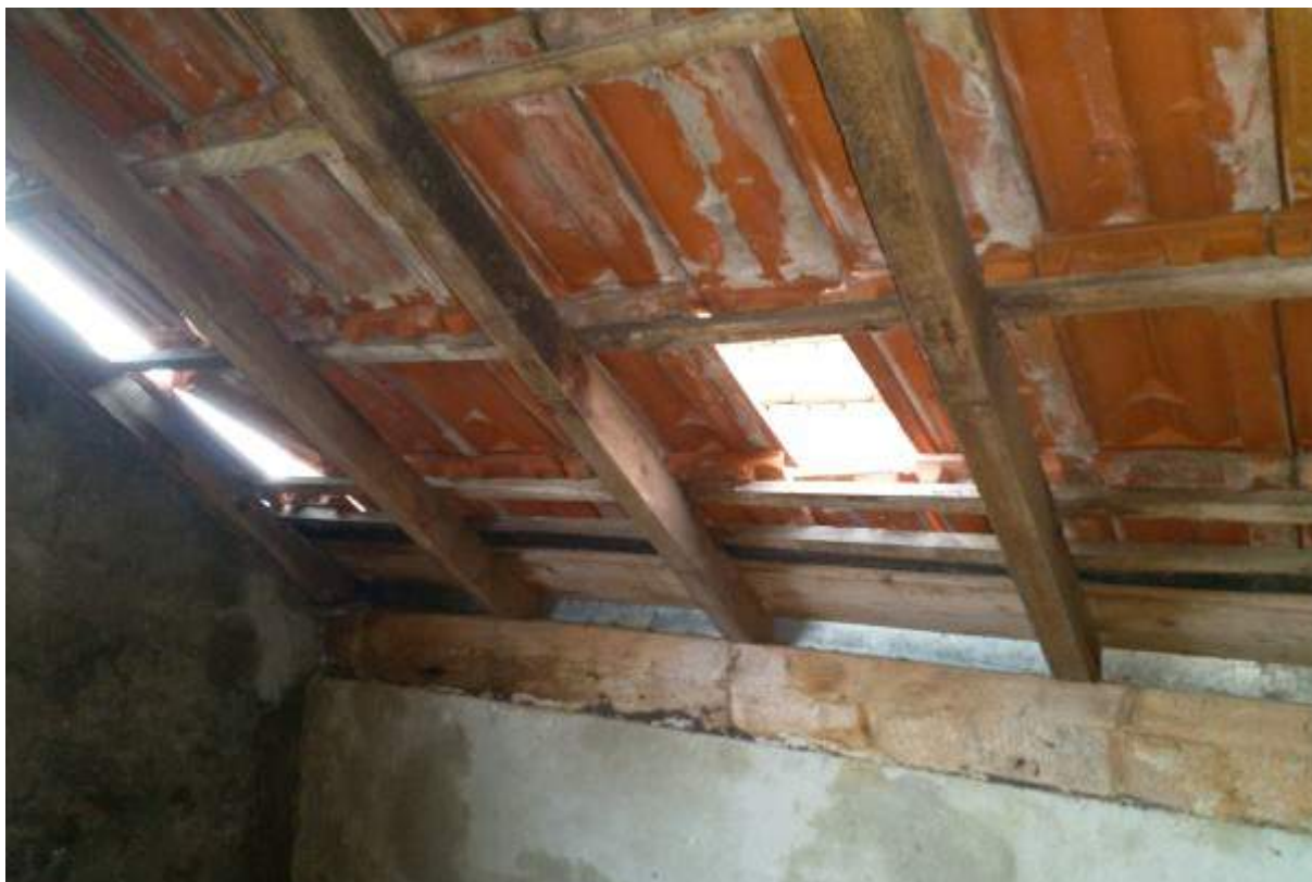
Onder het pannendak van het oostelijke deel van gebouw 3 is geen isolatiemateriaal aanwezig, waardoor door openingen de zolder direct toegankelijk is. Foto: M. de Vries | Ecoresult B.V.
