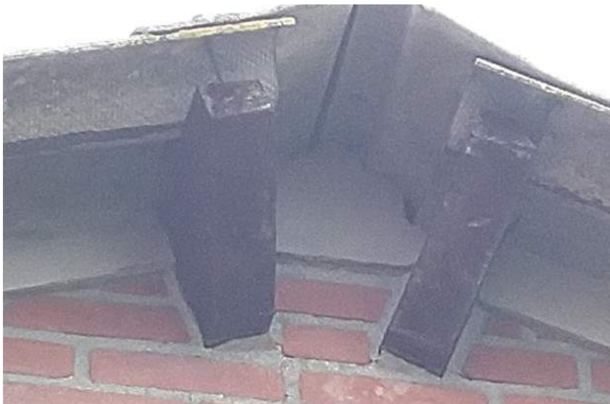
In de nok aan de zuidkant van gebouw 1 is een opening aanwezig die mogelijk gebruikt kan worden als verblijfplaats door vleermuizen. Foto: M. de Vries | Ecoresult B.V.
