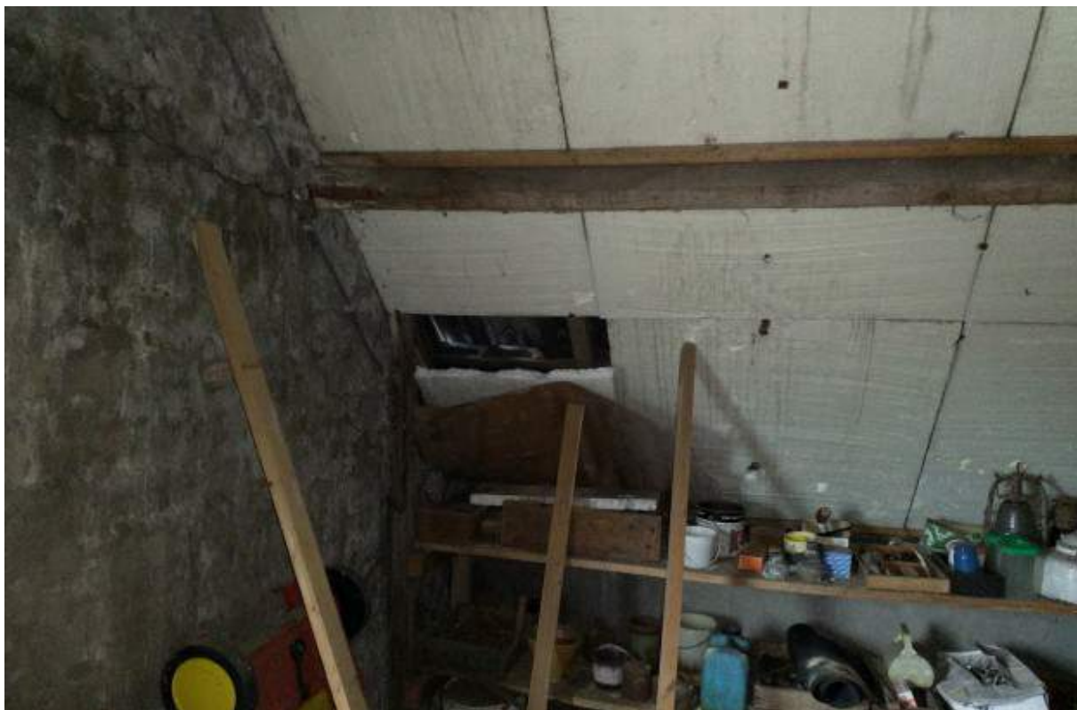
Onder het westelijke pannendak van gebouw 3 is isolatie aangebracht, waar echter ook gaten in zitten aan de binnenzijde. Foto: M. de Vries | Ecoresult B.V.
