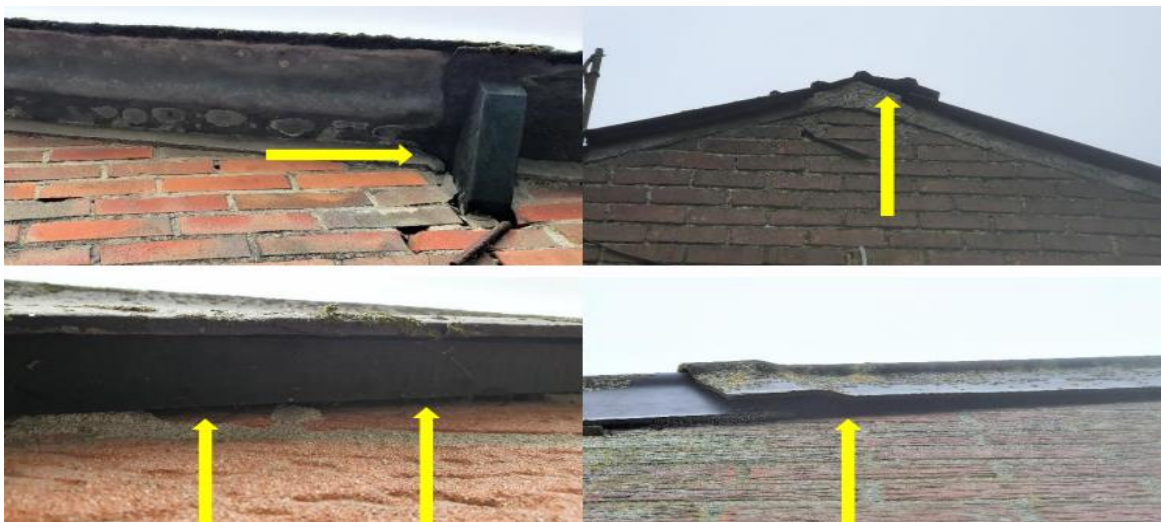
Op meerdere plekken in de kopgevels van opstallen 1 t/m 3 zijn spleten aanwezig waardoor vleermuizen onder de windveer of in de spouw kunnen kruipen. Bron: Aeres Milieu
