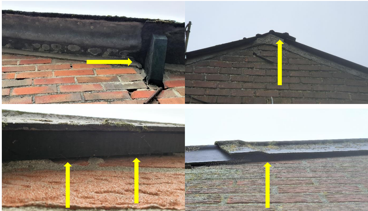
Figuur 4.4.3. Op meerdere plekken in de kopgevels van opstallen 1 t/m 3 zijn spleten aanwezig waardoor vleermuizen onder de windveer of in de spouw kunnen kruipen.
