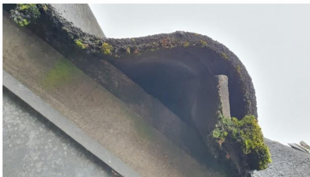
Figuur 4.4.1. Door de afwezigheid van vogelschroot kunnen vogels in de ruimte tussen de golfplaten en het dakbeschot van de opstallen nestelen.
