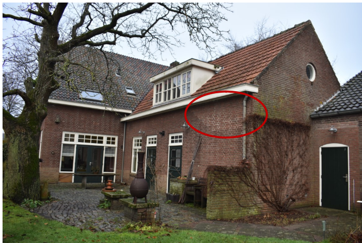
Rechterzijgevel tussenlid, herstelde oorlogsschade omcirkeld
