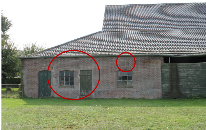
In de cirkels nieuw voegwerk. En in de grote cirkel sterk vervuild metselwerk.
