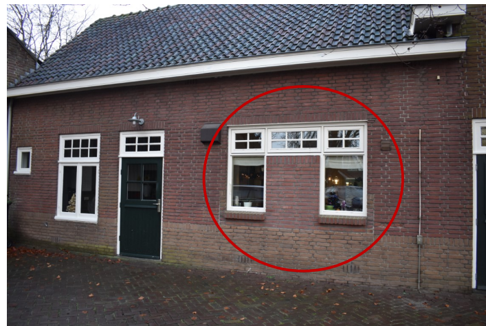
Zijgevel met aangepast metselwerk (cirkel)
