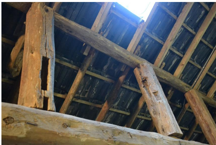
Sporen van oude verbindingen in de hergebruikte delen.
