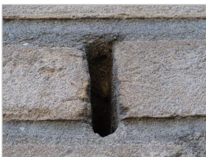
Foto 12: Open stootvoeg in gevel schoolgebouw.
