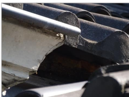
Foto 11: Openingen in dak bij schoolgebouw.
