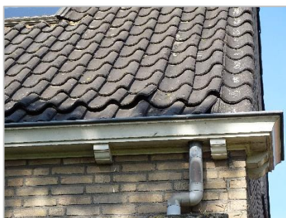
Foto 18: Lossen dakpannen achterzijde schoolgebouw.
