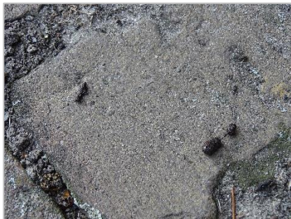
Foto 15: Uitwerpselen vleermuizen tegen gevel schoolgebouw.
