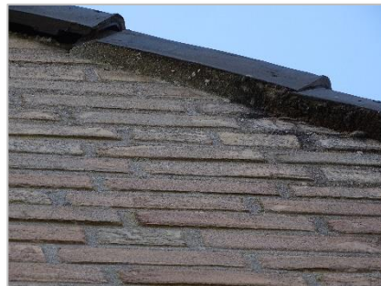
Foto 16: Ruime openingen dakrand boven vindplaats uitwerpselen vleermuizen.
