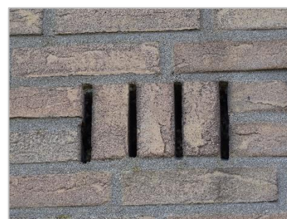
Foto 13: Open ventilatiegaten in gevel schoolgebouw.
