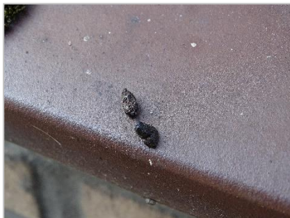
Foto 14: Uitwerpselen vleermuis op vensterbank schoolgebouw.
