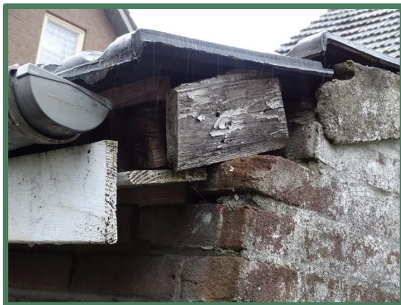
Gat op ongeveer 2 meter hoogte
