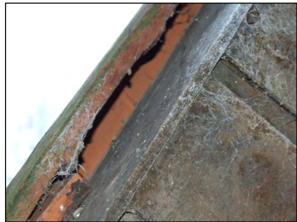
Figuur 10. De overhangende dakpannen vormen toegangsmogelijkheden tot de ruimtes onder het dak.
