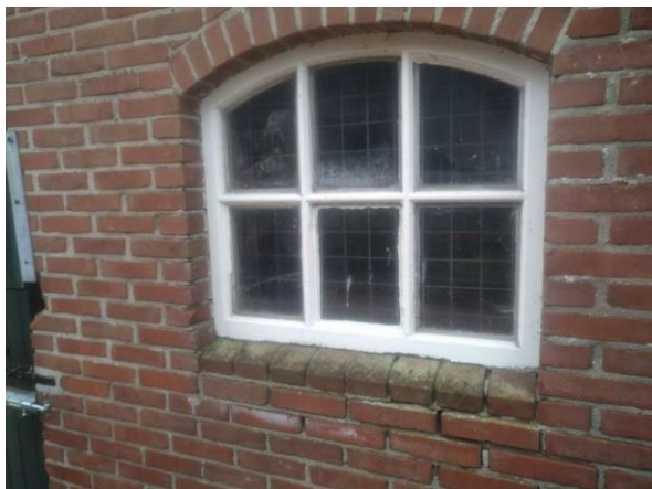
Beton geen asbest
