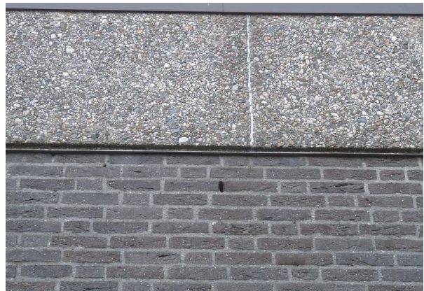
Figuur 8. Detail muur KPN-gebouw aan de zuidzijde, met open stootvoeg.
