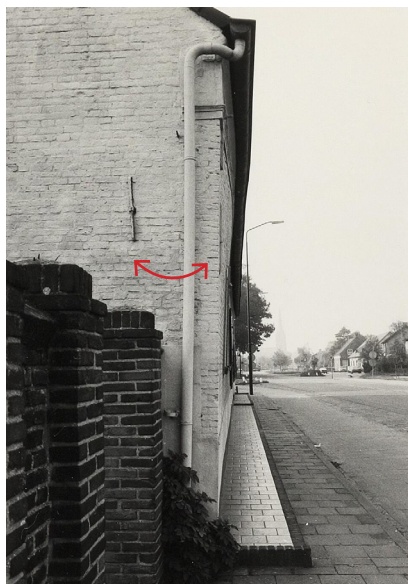
De lagenmaat van voor- en zijgevel komt niet overeen. De voorgevel staat aan de bovenzijde bol.
