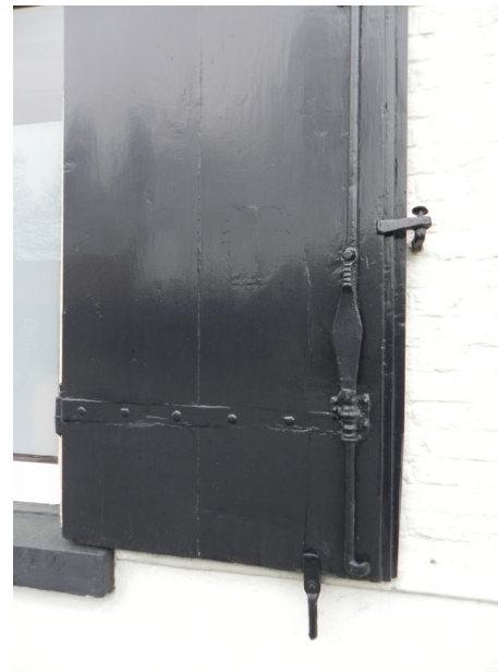
De oude luiken zijn in een perfecte staat en zijn voorzien van prachtig hang en sluitwerk, opvallend is de toepassing van dubbele luikwervels.
