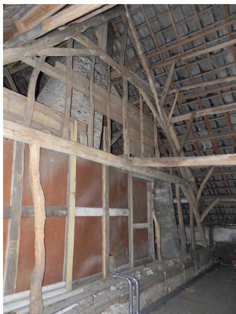
Restanten van scheidingwand tussen de zolders.
