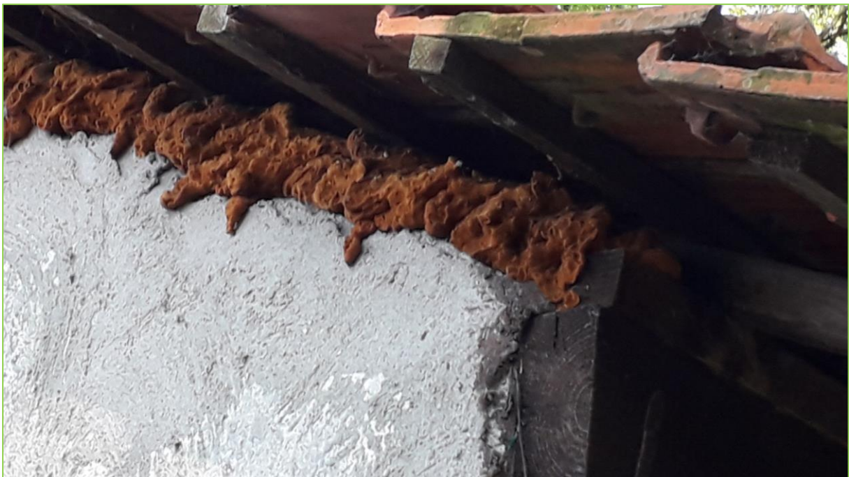
Ook het bijgebouw is voor een groot deel afgewerkt met afdichtingsmateriaal. Echter verkeerd dit materiaal in een relatief slechte staat.
