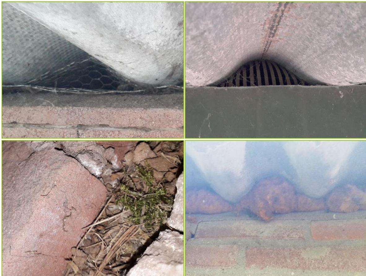
Figuur 2 Detailfoto's van de afdichtingen van de stallen. Linksboven: kippengaas, Rechtsboven: vogelschroot, Linksonder: bovenaanzicht spouw (dicht vanaf de tweede bovenste baksteen), Rechtsonder: opvulling met pur
