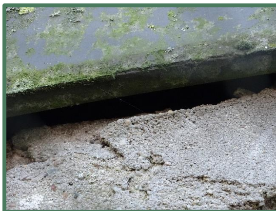
Foto 20: Kierende kantpannen noordelijke kopgevel schuur
