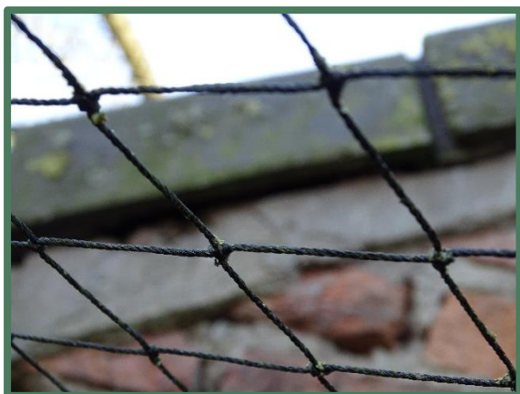
Foto 19: Kierende kantpannen noordelijke kopgevel schuur
