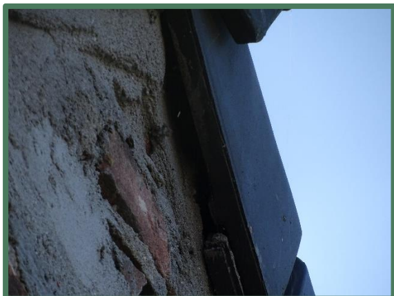
Foto 21: Kierende kantpannen noordelijke kopgevel schuur
