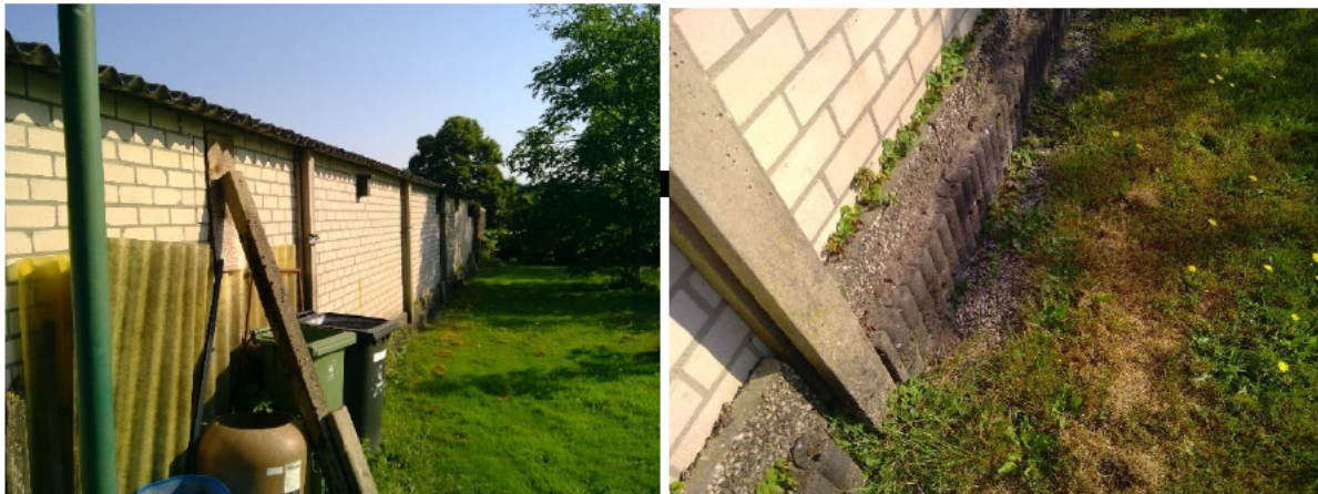
(foto's: druppelzone noordelijke gevel garage)
