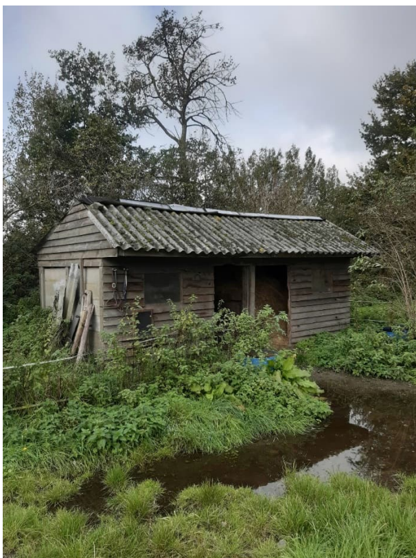
Afbeelding 4: Schuurtje met asbestverdacht dak
