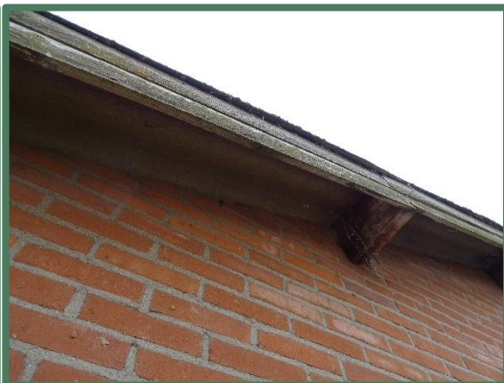
Foto 6: Overstek betimmering westgevel noordelijke stal sluit aan.
