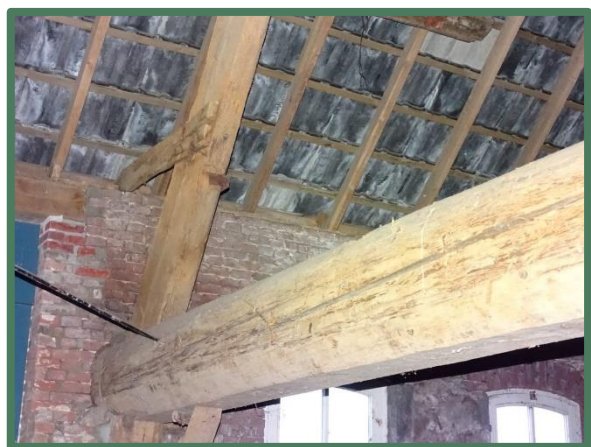
Gebrek aan dakbeschot
