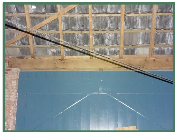
Gebrek aan ruimte tussen de balk over de deur en het dak
