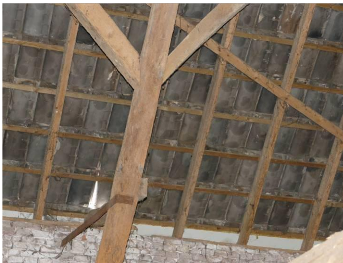
Figuur 24 – De lange veer van een muuranker, verbonden met een spantbeen.
