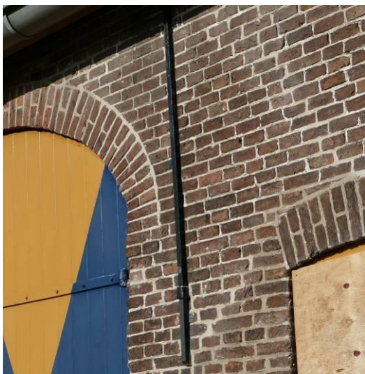
Figuur 23 – Muuranker in de voorgevel.
