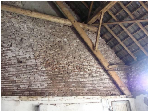
Figuur 59 – Het spant wat zich bevindt op de verdikking in de brandmuur.
