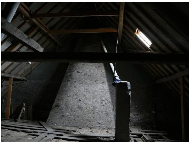
Figuur 54 – Het rookkanaal tegen de brandmuur op de zolder.
