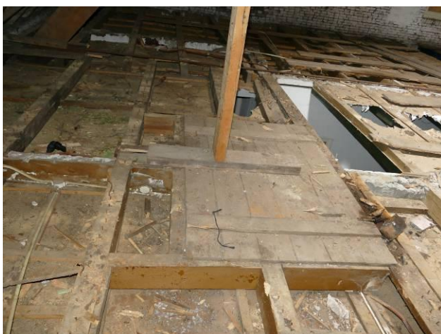
Figuur 49 - De raveling ten behoeve van de voormalige opgang van geut naar zolder.
