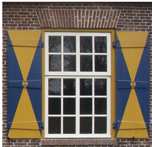
Figuur 22 – Raam van het woongedeelte met slordig uitgevoerde herstelling van de strek.
