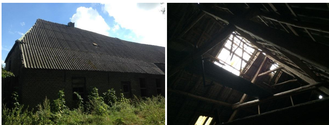
Figuur 2. Impressie van de woonboerderij in vervallen staat, wat te zien is aan het dak.
