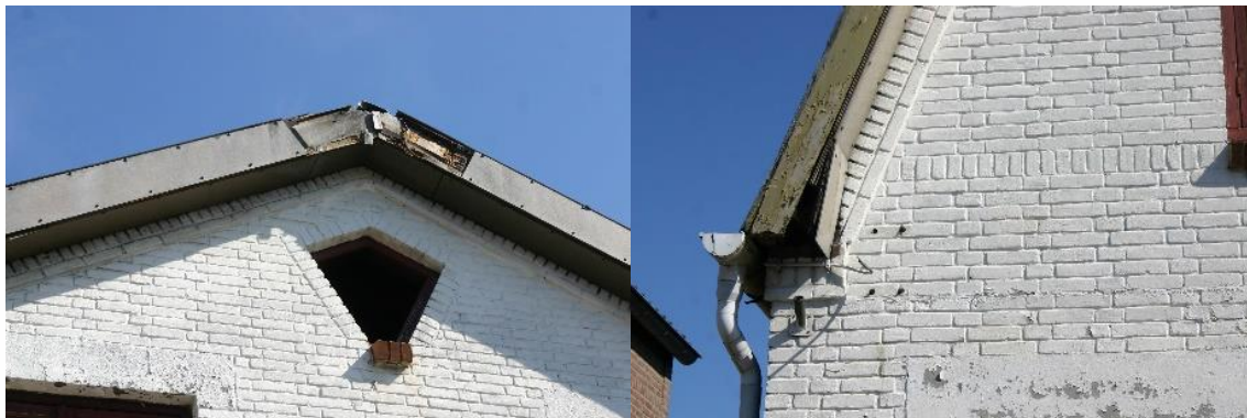
Figuur 4.4.4 De beschadigde windveer aan de voorgevel.
