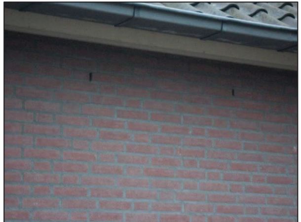
Foto 2. Open stootvoegen in de gevel
