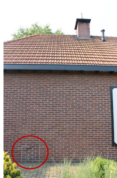
Rechts op de begane grond een dichtgezette sparring (pijl)
