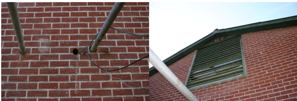
Figuur 4.5.2. Gaten (foto links) en ventilatieroosters foto rechts) in de buitenmuren van de bebouwing.
