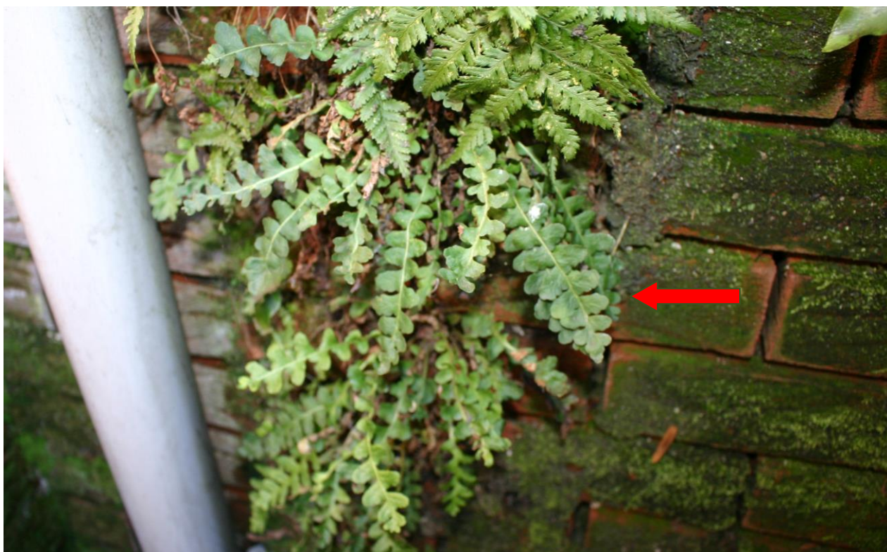
Figuur 4.5.4. Schubvaren (rode pijl) op de zuidwestzijde van de muur tussen de twee meest zuidelijk gelegen stallen.
