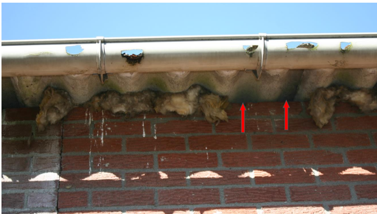
Figuur 4.5.1. De ruimtes onder de golfplaten daken zijn grotendeels opgevuld met steenwol. Op sommige plekken ontbreekt deze (rode pijlen) en is er plaats voor vogelnesten.
