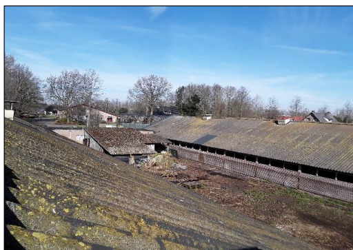
Overzicht opstal 1 opslagruimte en opstal 2 (daken) Asbesthoudend
