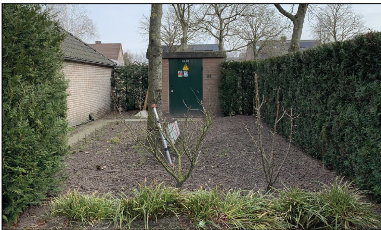
Figuur 15: Transformatorhuisje naast het plangebied
