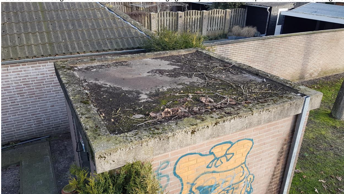
Foto 9: het transformatorhuisje heeft geen gaten in de gevels naar de onderzoekslocatie toe.
