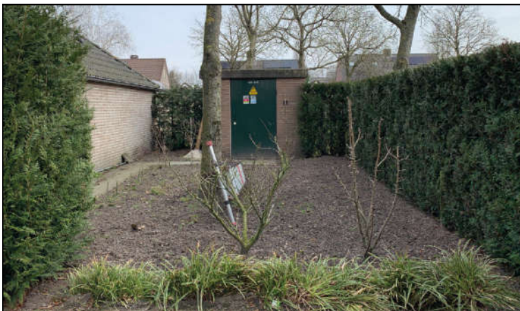
Figuur 17: Transformatorhuisje naast het plangebied
