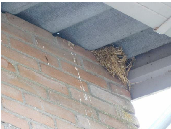
Nest onder zuidwestelijke dakrand
