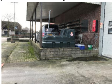
foto 4 - bovengrondse dieselolie tank
