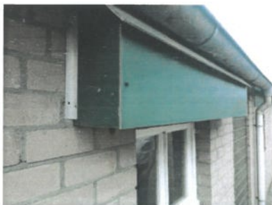
Foto 11 trespa ventilatieklep bij opstal 2
